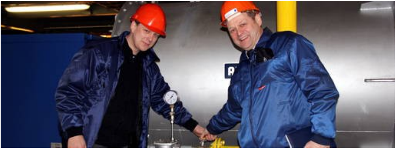
Deusa-Geschäftsführer Michael Pfeiffer (rechts) und Deusa-Technologieleiter Robert Koitz an der neuen Trocknungsanlage des Bleicheröder Kali-Betriebes. Mit dieser Anlage soll die Produktpalette des Unternehmens erweitert werden. Foto: Hans-Peter Blum
